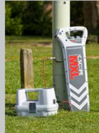
SÄHKÖKAAPELIDEN PAIKANNUKSET C.Scope MXL kaapelitutkalla
