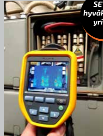
SÄHKÖLAITTEISTOJEN LÄMPÖKAMERAKUVAUKSET Fluke lämpökameroilla
